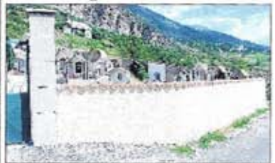
Plus de deux mois et demi ont été nécessaires pour la remise en état de la totalité des murs du cimetière de hameaux de Saint-Marcellin. Dans un triste état, ces derniers ont désormais retrouvé leur apparence initiale : crispis ocres et couvertures en tuiles rouges. L'entrepreneur Michel Delaunay, est désormais en train de réaliser la suite du chantier, à savoir la réfection des murs du cimetière de la commune.
